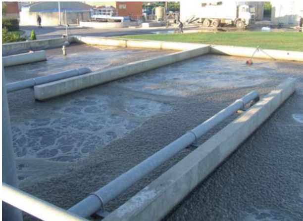
Foto 11. Línea 2 reactor 1 con dosificación de ozono en los 2 reactores (05/11/2008)
