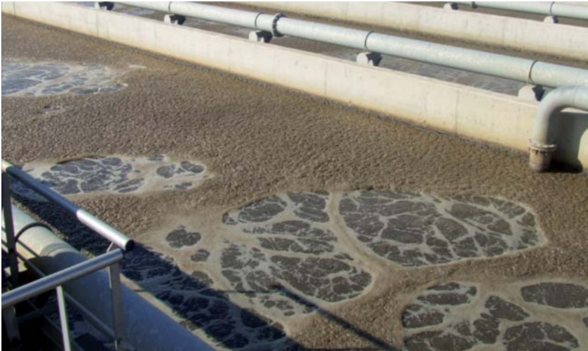
Foto 3. Reactor biológico línea 1 sin dosificación de ozono
