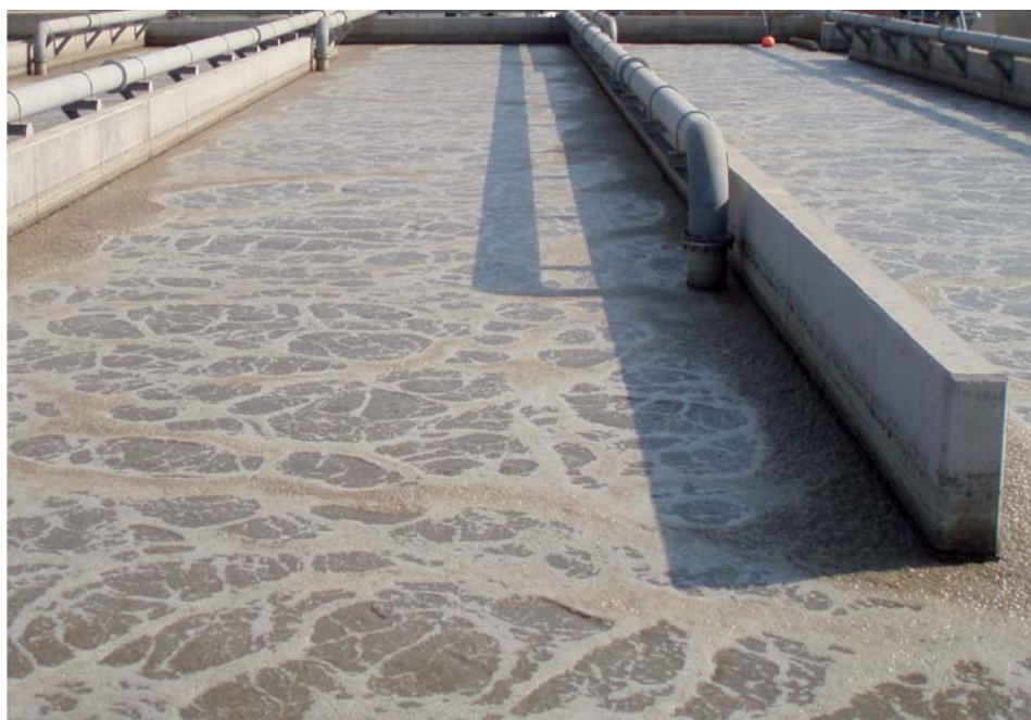
Foto 5. Reactor biológico línea 1 con dosificación de ozono
