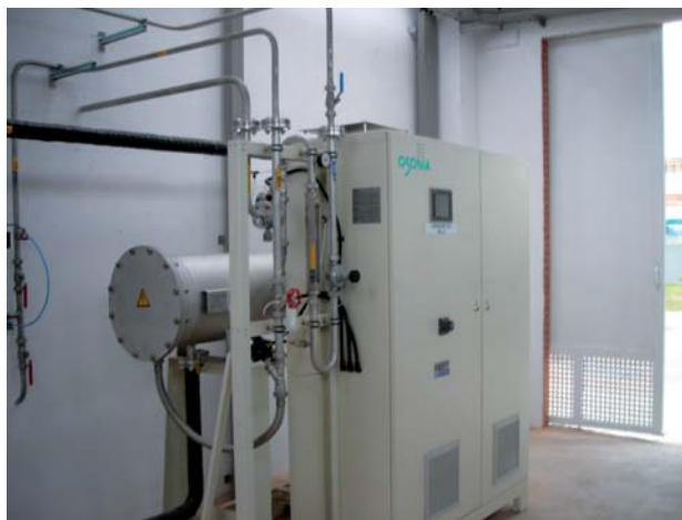
Foto 1. Generador de ozono
