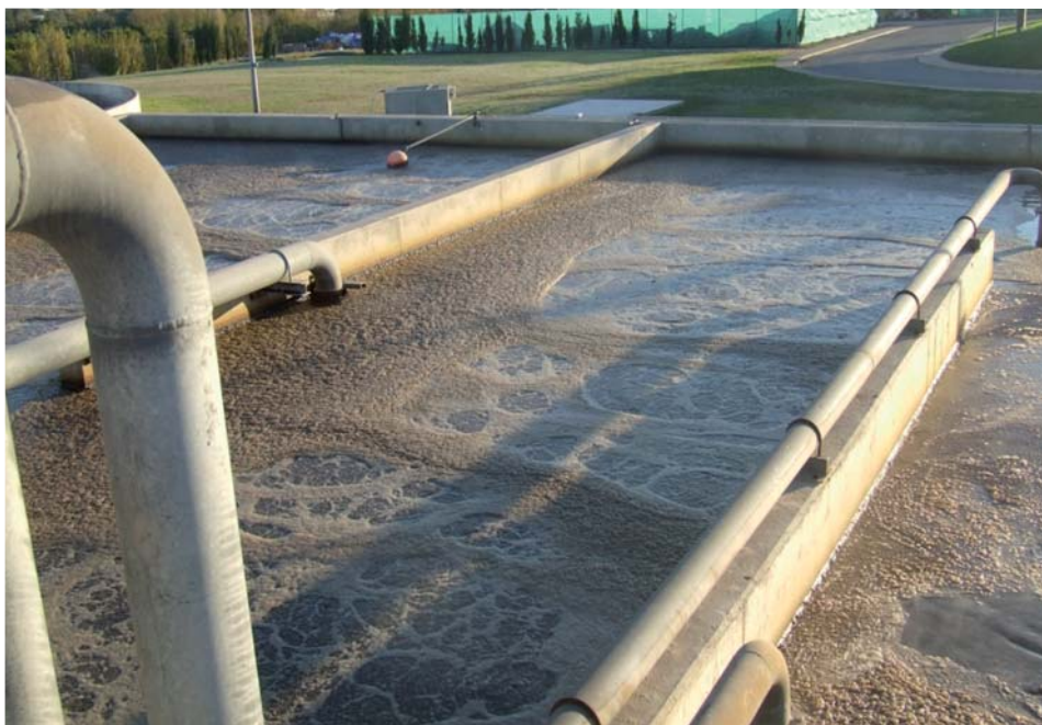
Foto 6. Reactor biológico línea 2 con dosificación de ozono
