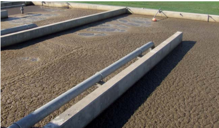
Foto 4. Reactor biológico línea 2 sin dosificación de ozono
